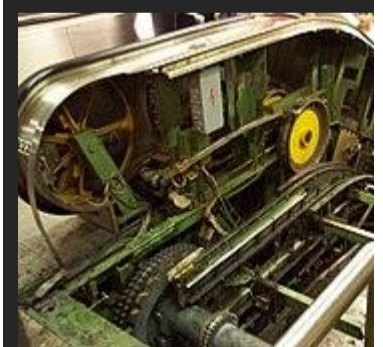
Escalera Mecánica desarmada para mantenimiento profundo, Imagen de Internet.
